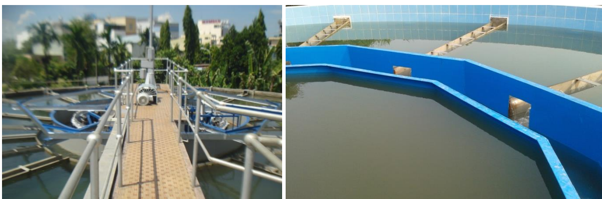
Hình 2: Cụm xử lý nước của Công ty Cổ phần Cấp thoát nước Cần Thơ
