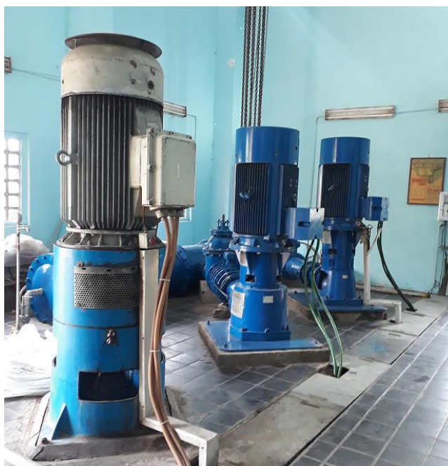
Hình 1: Hệ thống bơm nước sạch của Công ty Cổ phần Cấp thoát nước Cần Thơ
